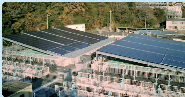
奥平野浄水場太陽電池パネル
